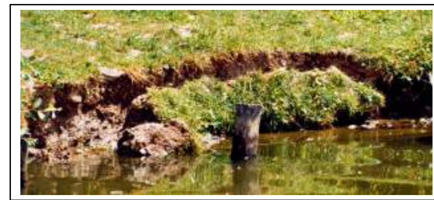
Berge dégradée sur les bords de l'Erdre
