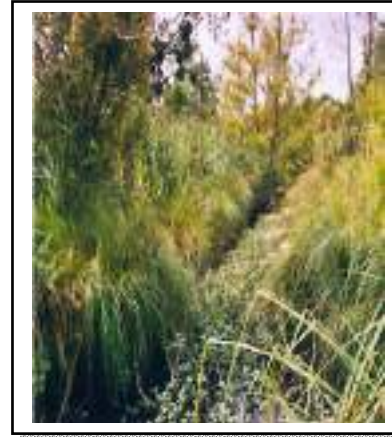
Fermeture d'une douve par la végétation
